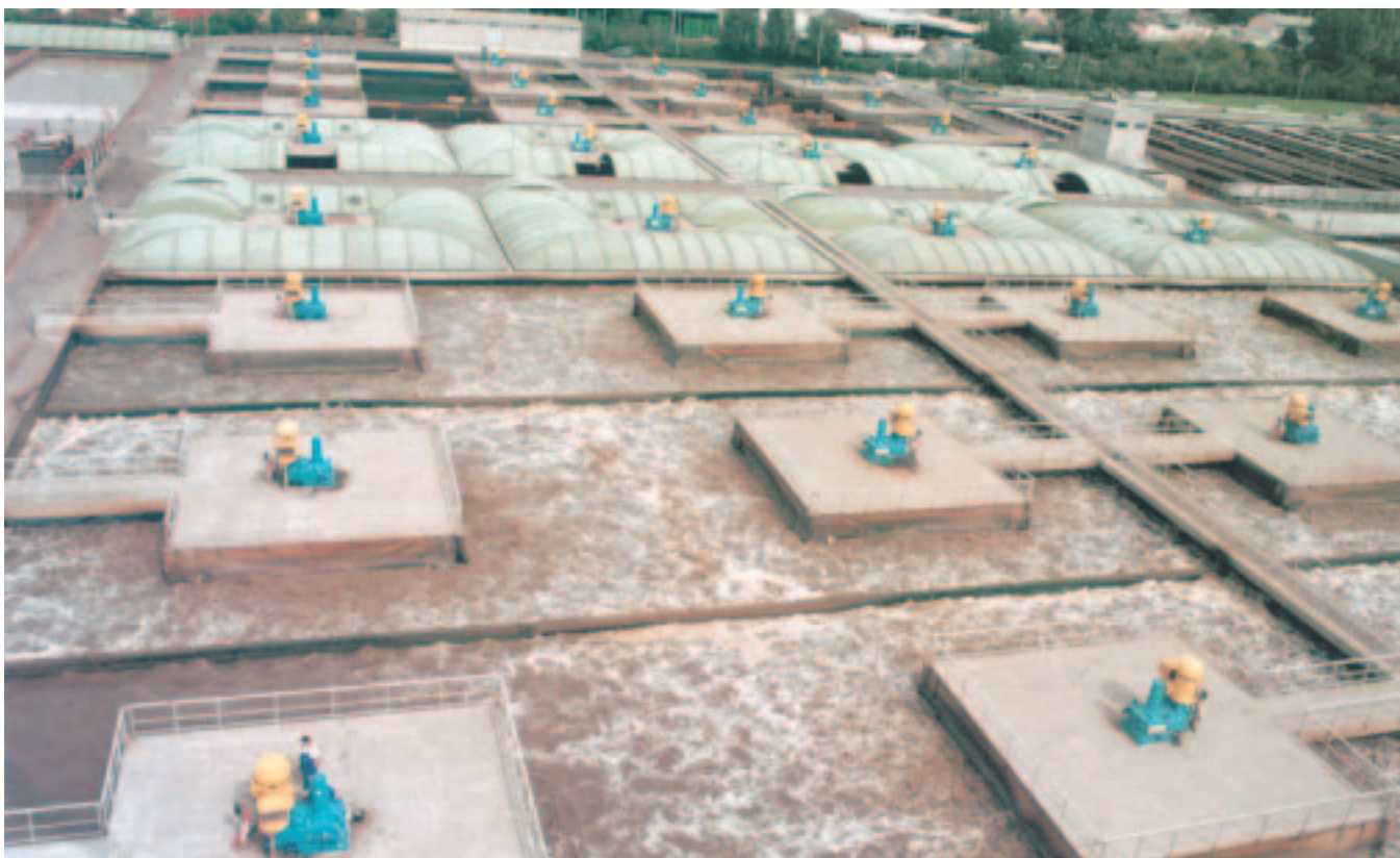
Kläranlage in Wien, Österreich, ausgerüstet mit FLENDER-Zahnradgetrieben Sewage treatment plant in Vienna, Austria, equipped with FLENDER gear units Station d'épuration à Vienne, Autriche, équipée avec FLENDER réducteurs à engrenages
